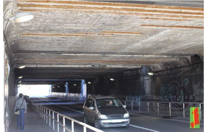
S-Bahnhof Bochum Langendreer / B 235 Angstraum / Instandsetzungsbedürftige Brücke
